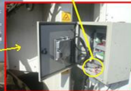
Cuadro eléctrico (identificación de señales) - Alimentación - Trabajo (sacudidores)
